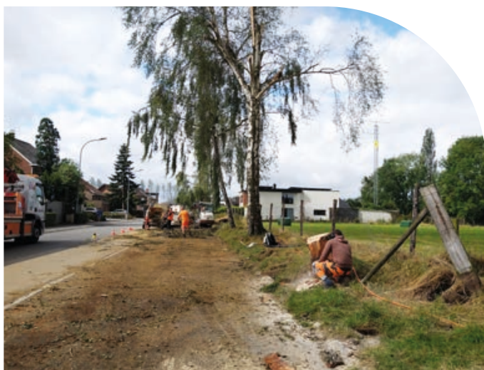
Groendienst aan het werk na de storm
